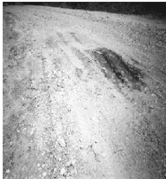
Fig. 7. Degradări din îngheț-dezgeț Frost-defrost degradings
